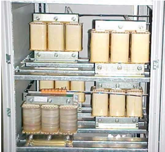
Disposición de reactores en filtro automático
