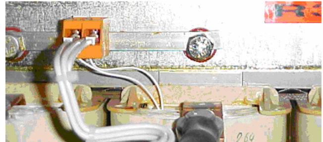
Sensor de temperatura en el reactor
