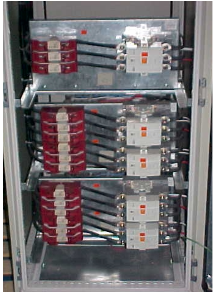
Contactores y fusibles
