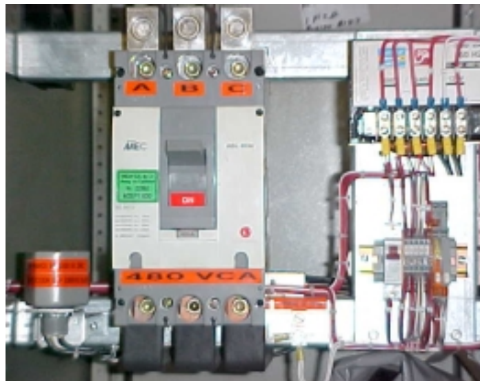
Interruptor termomagnético general
